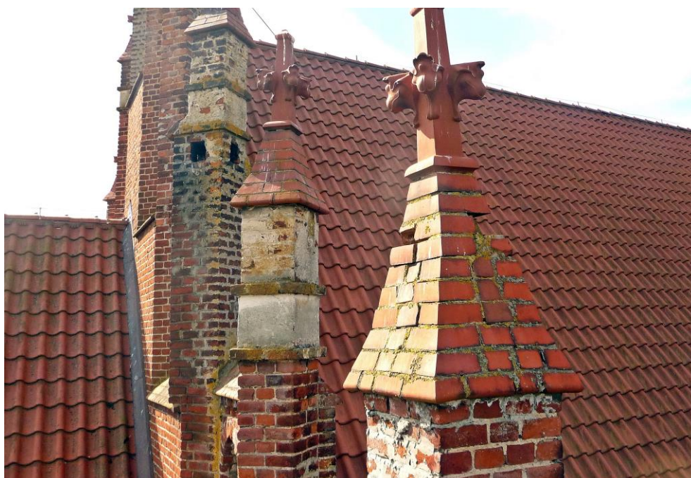
Zbliżenie wtórnych tynków oraz uszkodzenia na sterczynie.
