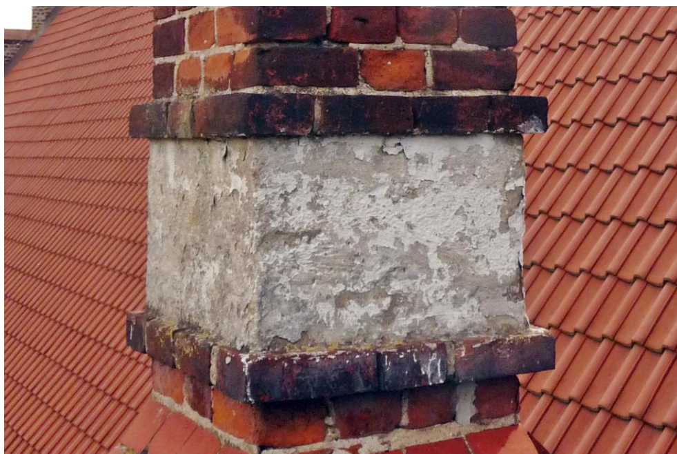
Zbliżenie wtórnego, cementowego tynku.
