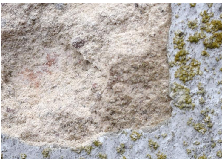
Zbliżenie pozostałości powierzchni tynków pierwotnych
