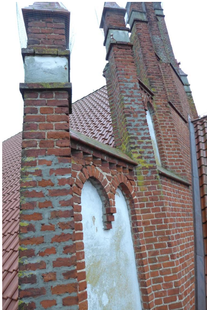
Zbliżenie uszkodzeń wątku i parapetu
