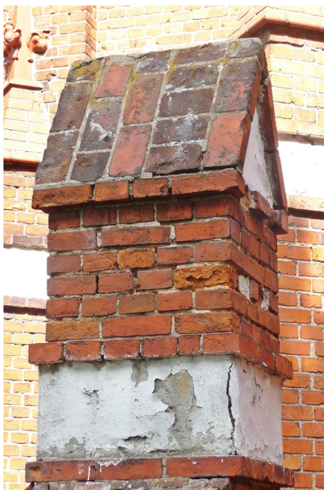
Widok uszkodzeń sterczyn.
